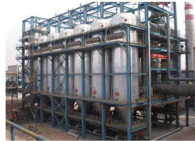
宣钢 2500m 3 高炉煤气干法除尘系统 Dry dedusting system for Xuangang 2500m 3 BF gas
