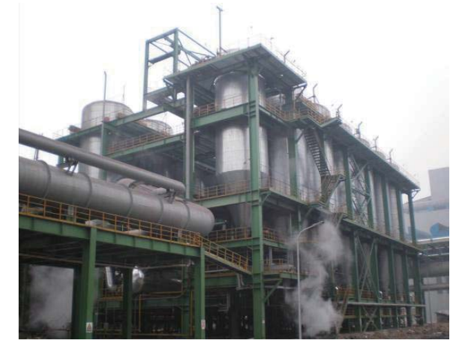
首钢迁钢 4000m 3 高炉煤气干法除尘系统 Dry dedusting system for Shougang Qiangang 4000m 3 BF gas
