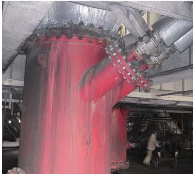
上出料流化喷煤罐 Upper discharge fluidizing PCI hopper
