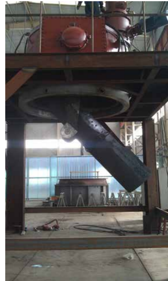
炉顶设备车间内试车
